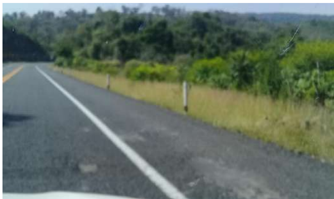
Necesidad de calabero y bacheo en tramo 2
