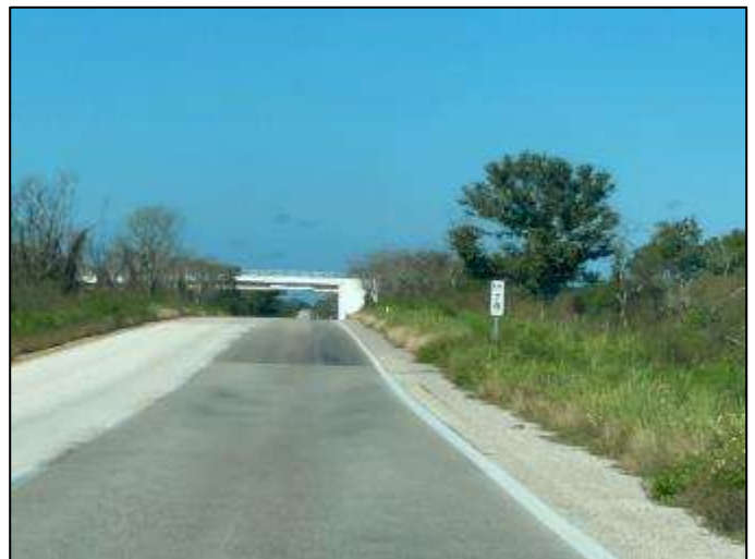
Raya blanca continua, requiere mantenimiento, km 78+000.
