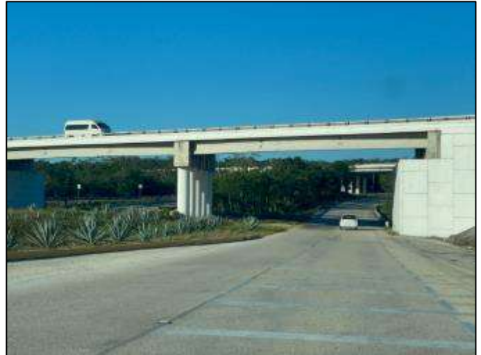
Entronque “Tintal-Playa de Carmen”, buenas condiciones, km 238+000.
