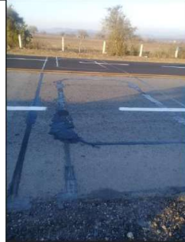
Sensores y circuitos inductivos instalados en el piso que cuentan el peso y los ejes del vehículo, conectado con la estación de medición, sin detener el flujo.
