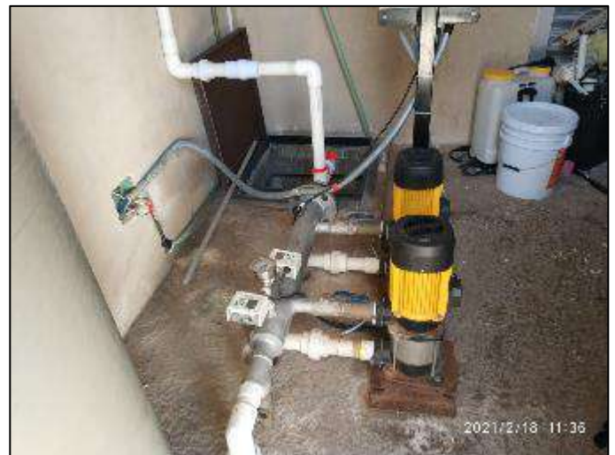
Instalaciones de hidrosanitarias, en Plaza de cobro "Tintal" en buenas condiciones, km 237+700.
