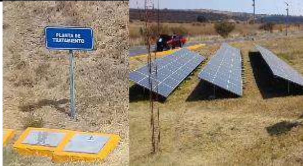
Cuentan con una planta de tratamiento que no está en funcionamiento, los paneles solares ayudan con la energía eléctrica necesaria diaria en razón de un 30-40%.
