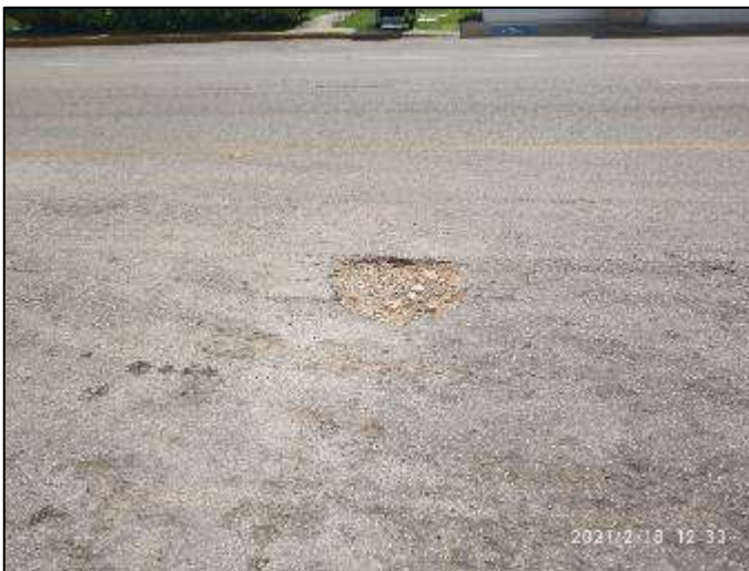
Falta de mantenimiento en km 216+600
