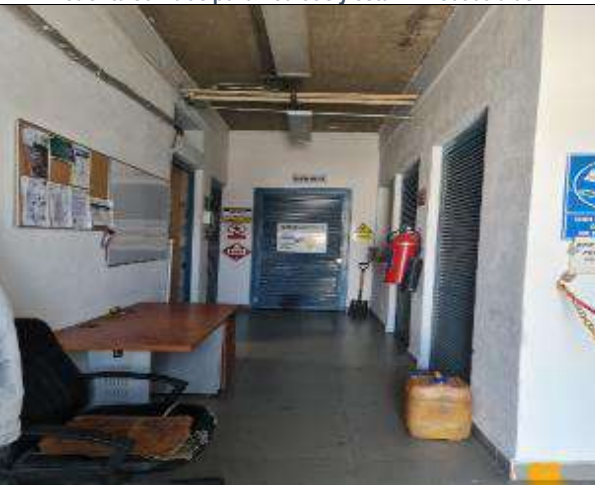
Área de mantenimiento y cuarto de máquinas, está en reparación el sistema neumático.
