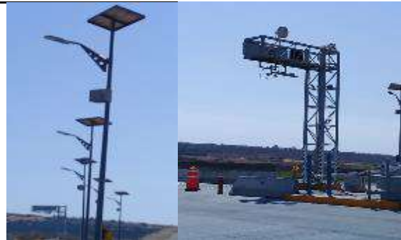
La luminaria es a base de paneles solares, los protocolos son obsoletos y debido a un rayo en agosto del 2020 dos carriles exclusivos se encuentran cerrados.
