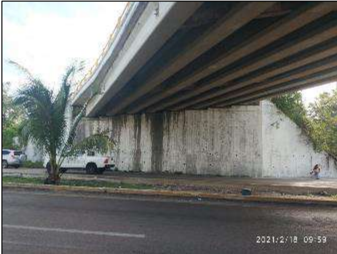
PSV 307+500 “Colosio”, falta de mantenimiento.
