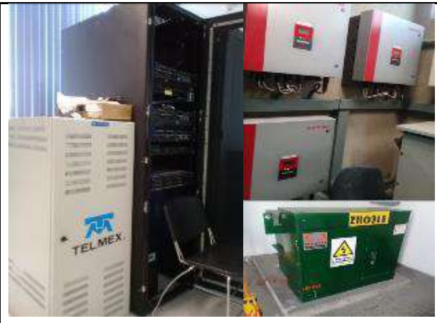
Site con el servidor de SIMEX y las cámaras del circuito cerrado del edificio (28 cámaras), cuentan con un NO-break y un supresor de picos para su protección; del lado derecho los inversores de los paneles solares y la planta de 150KVA suficiente para la caseta troncal
