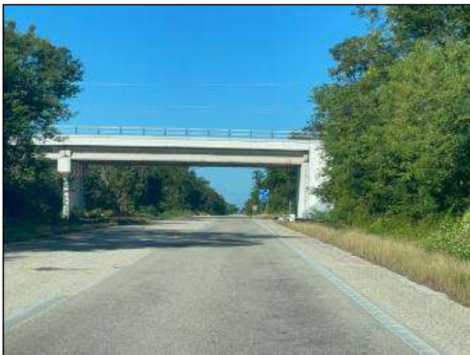
Línea de vibración, en buen estado físico, km 130+000.
