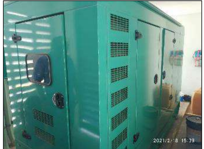
Planta de emergencia en Plaza de cobro "Chichen-Itzá", en buenas condiciones, km 115+500.
