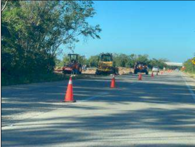
Inicio de obra de Cancún-Kantunil, km 172+500 y terminación en el km 171+500, aproximadamente km 1.
