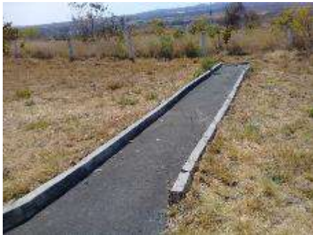
Bordillos del lavadero no completos, sin embargo ya no son necesarios debido a que el suelo ya está consolidado.
