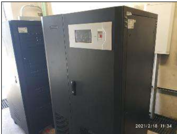
Subestación eléctrica en Plaza de cobro "Tintal", se observó una falla de voltaje en el equipo de UPS, se requiere reparación o cambio de equipo, km 237+700.
