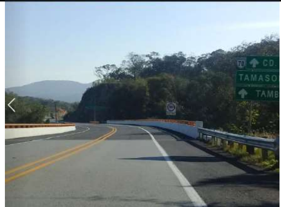
Conservación mayor realizada en la superficie de rodamiento, nótese el material calizo y basáltico en buen estado
