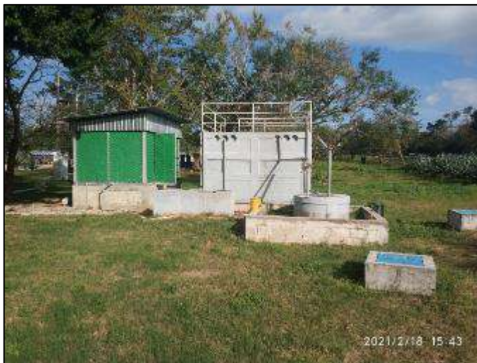
Planta de tratamiento en Plaza de cobro "Chichen-Itzá", en buenas condiciones, km 115+500.
