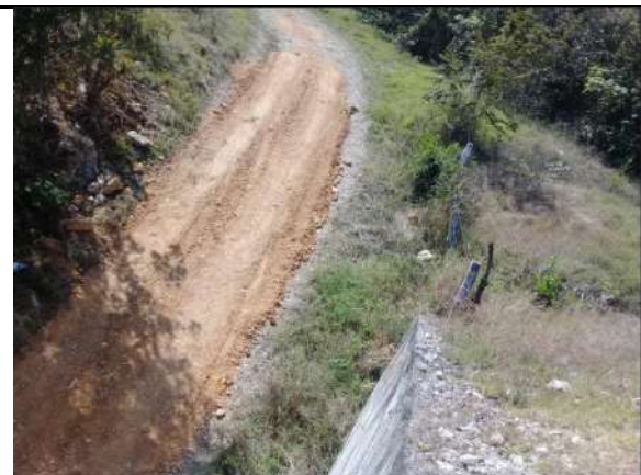
Obras de drenaje ampliadas por petición de la comunidad que también fungen como paso inferior peatonal y/o paso de ganado.
