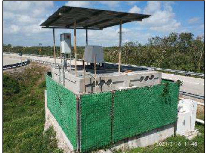
Planta de tratamiento de en Plaza de cobro "Tintal", en buenas condiciones, km 237+700.
