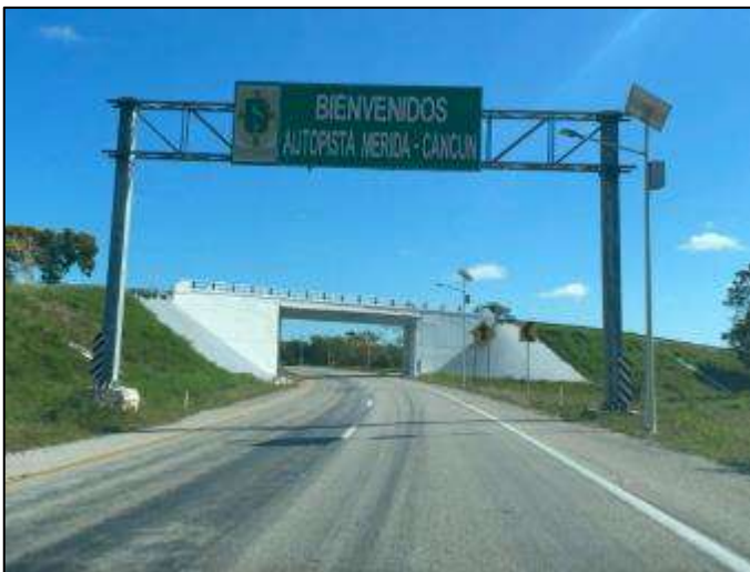
Entronque “Kantunil”, se requiere mantenimiento en el pavimento, km 65+500.
