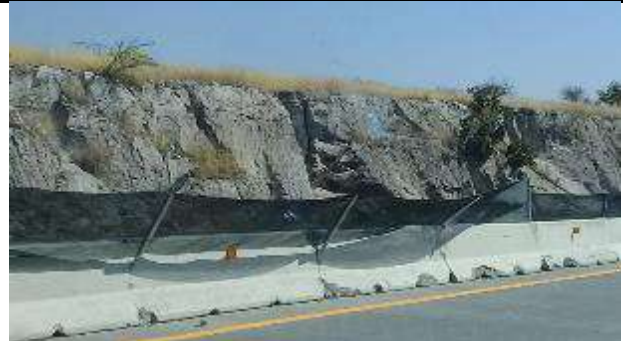
Malla intermedia mal colocada y en algunos tramos es inexistente, en almacén está la nueva malla a colocarse con mejor calidad.
