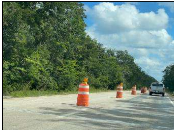
Reductores de velocidad, sentido Kantunil-Cancún, requiere mantenimiento, km 143+000.
