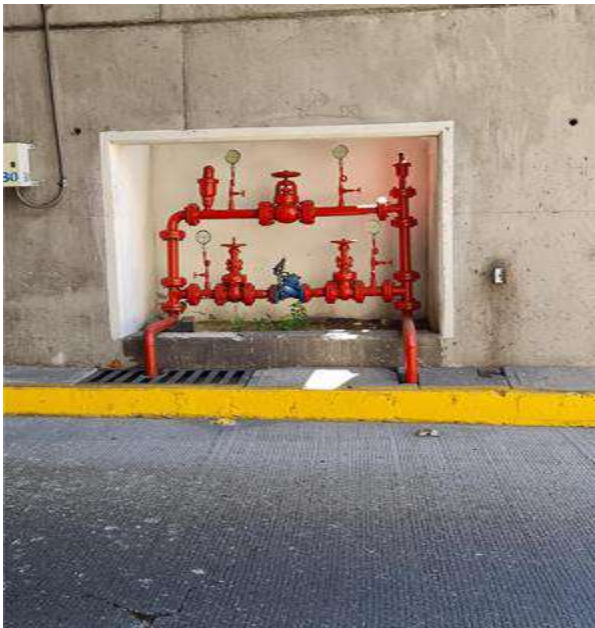
Hidrantes dentro del túnel, en buenas condiciones físicas.
