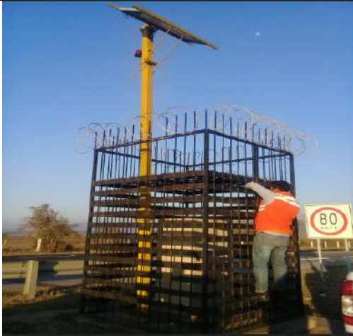
1 de las 7 estaciones de medición, cuenta con paneles solar que la hace autosuficiente, los 3 candados, la concertina, la estructura metálica y púas es para prevenir el vandalismo o saqueo de los equipos.
