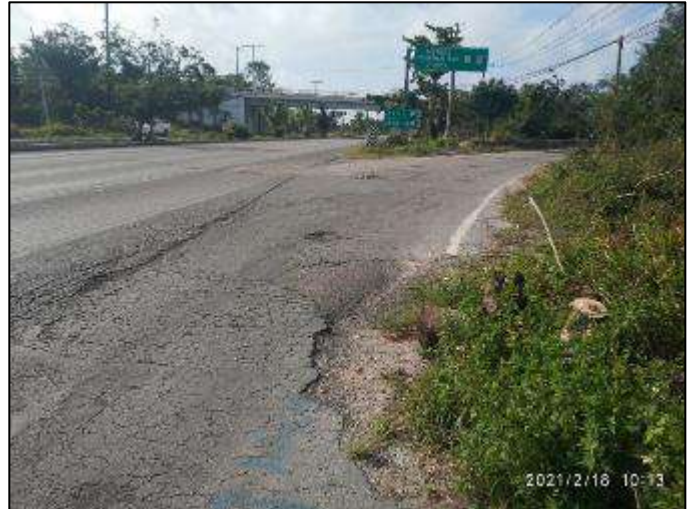
Falta de mantenimiento en 307+500 inicio de ramal “Aeropuerto”.
