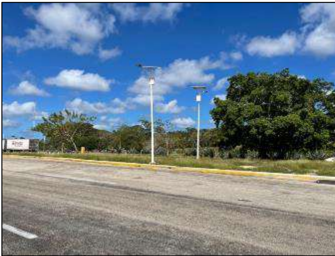
Iluminación de vialidad en la Plaza de cobro "Chichen-Itzá", en buenas condiciones, km 115+500.
