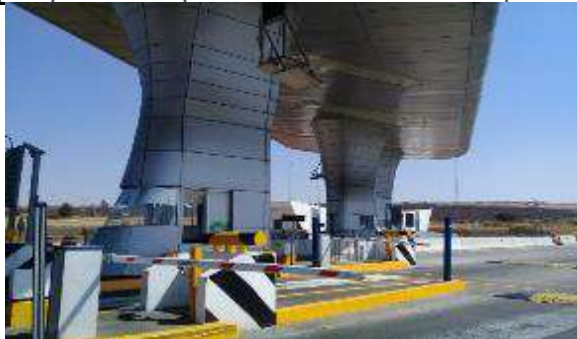
Caseta troncal en funcionamiento, tiene barrera de paso, cortina óptica, sensor dinámico de conteo de ejes y peso, cámara en domo (dentro de caseta de cobro) cámara para placa y panorámica.
