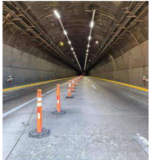
Raya blanca continua y raya blanca discontinua sencilla, en buenas condiciones físicas.
