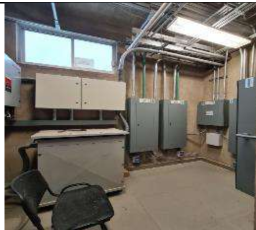
Cuarto de tableros eléctricos e inversores de los paneles solares, todos bien señalizados, algunos están automatizados como los reflectores en casetas.
