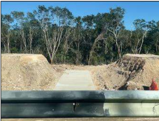
Obra en proceso Cancún-Kantunil, km 140+000 y terminación en el km 130+00, aproximadamente km 10.
