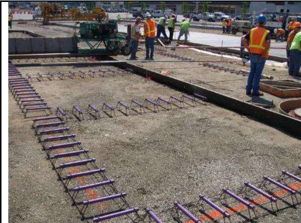
Imagen ilustrativa: Base hidráulica terminada, sobre esta se coloca la canastilla metálica con pasajuntas de redondo de acero. Según el método constructivo esto puede ser llevado a cabo en un solo proceso.
