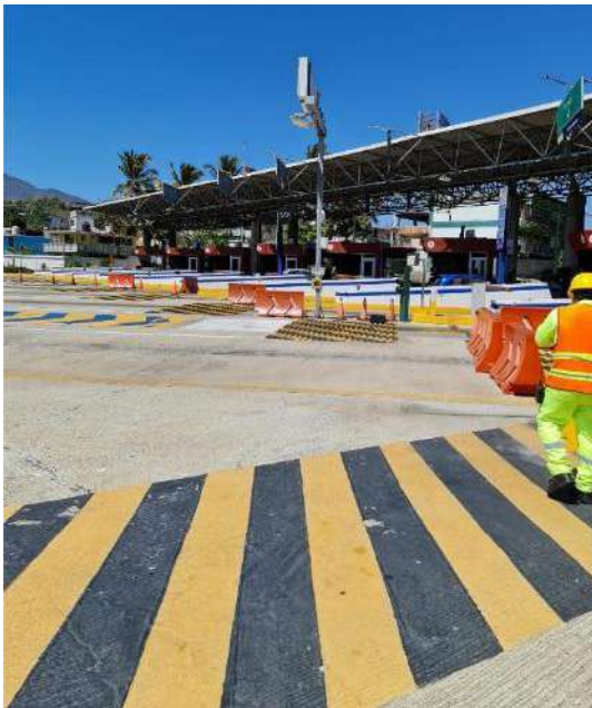
Paso cebra, en buenas condiciones físicas.
