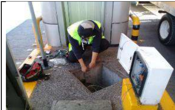
Encontramos gente de SIMEX haciendo mantenimiento a su sistema.
