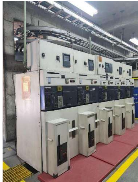
Transformadores, en buenas condiciones físicas.
