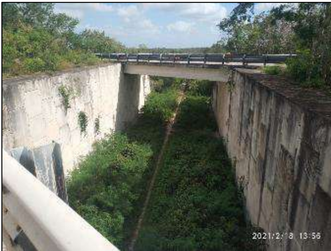
Paso de ferrocarril, se requiere mantenimiento, km 142+800.
