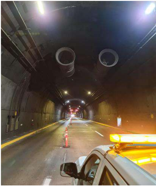
Ventiladores con detectores de monóxido de carbono dentro del túnel, en buenas condiciones físicas.
