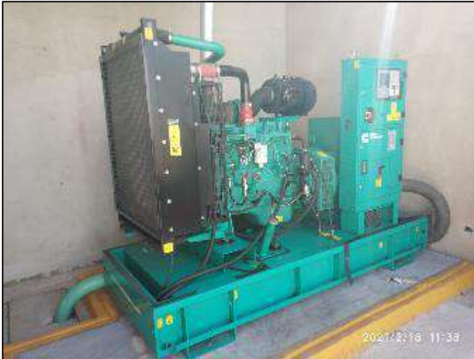
Planta de emergencia, en Plaza de cobro "Tintal", en buenas condiciones, km 237+700.
