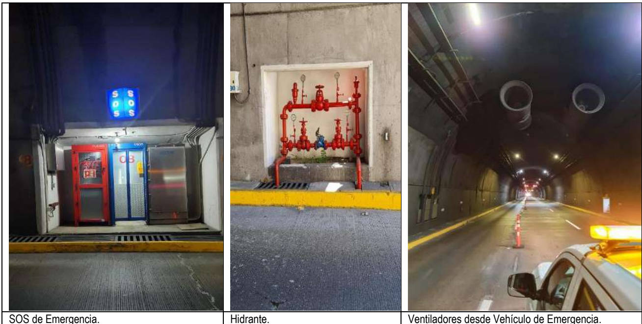
Ilustración 8. Sistemas del Túnel
