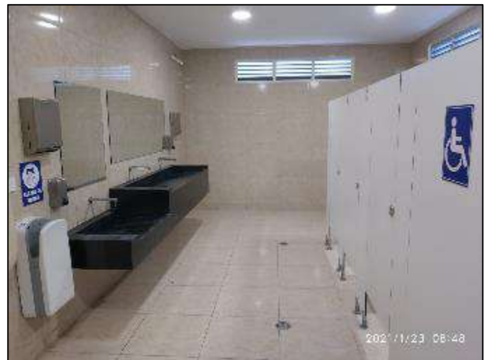
Instalaciones de sanitarios en Plaza de cobro "Tintal" en buenas condiciones, km 237+700.
