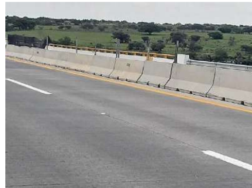
Daños en la malla vial sobre la autopista
