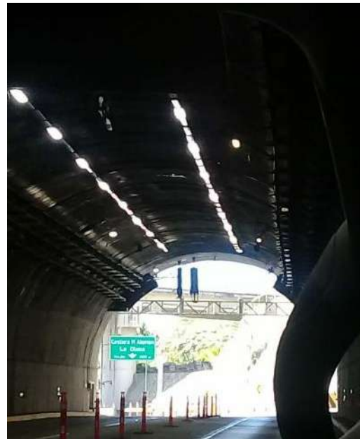
Dispositivos de iluminación, en buenas condiciones físicas.
